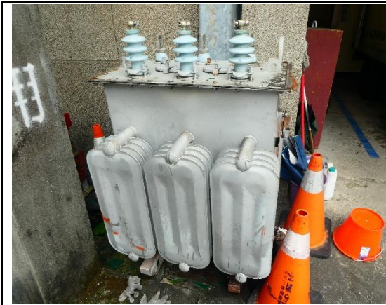
油浸式高壓變電器(圖一)
