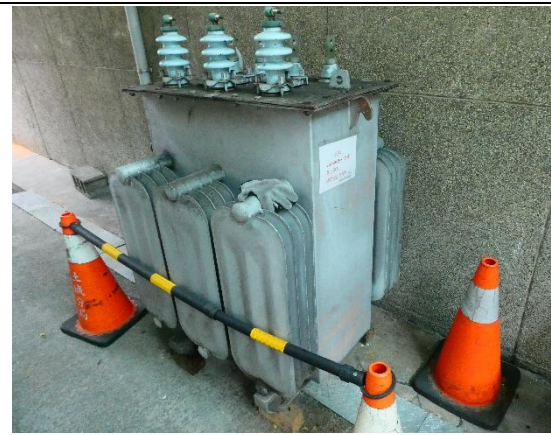
油浸式高壓變電器(圖二)
